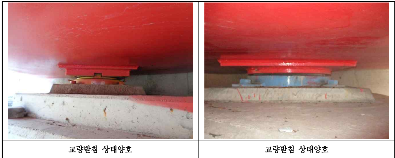
【사진 35.3.11】 교량받침 손상현황
