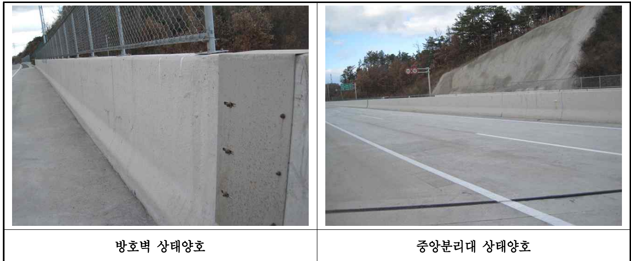
【사진 35.3.43】 방호벽 및 중앙분리대 손상현황
