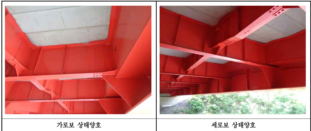
【사진 35.3.28】 가로보 및 세로보 손상현황
