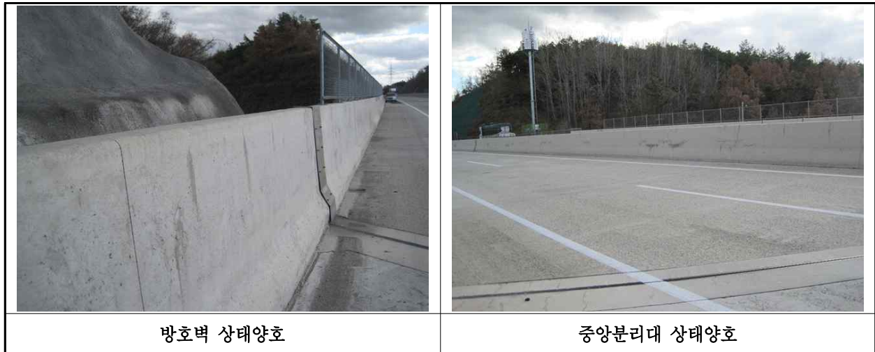
【사진 35.3.22】 방호벽 및 중앙분리대 손상현황
