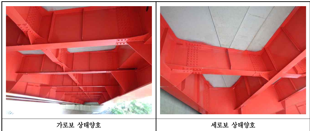
【사진 35.3.7】 가로보 및 세로보 손상현황
