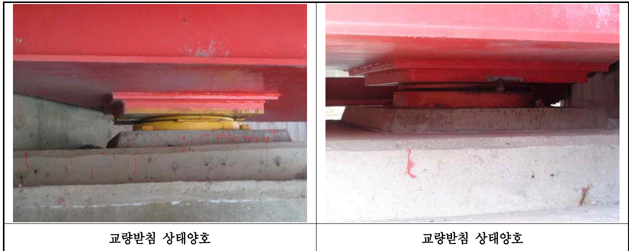
【사진 35.3.32】 교량받침 손상현황
