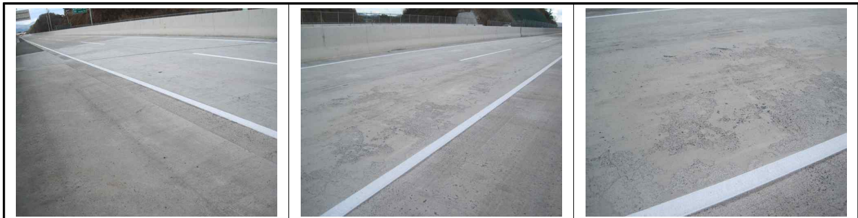
① 교면포장 망상균열 및 보수재 박락 - 진전 여부확인
