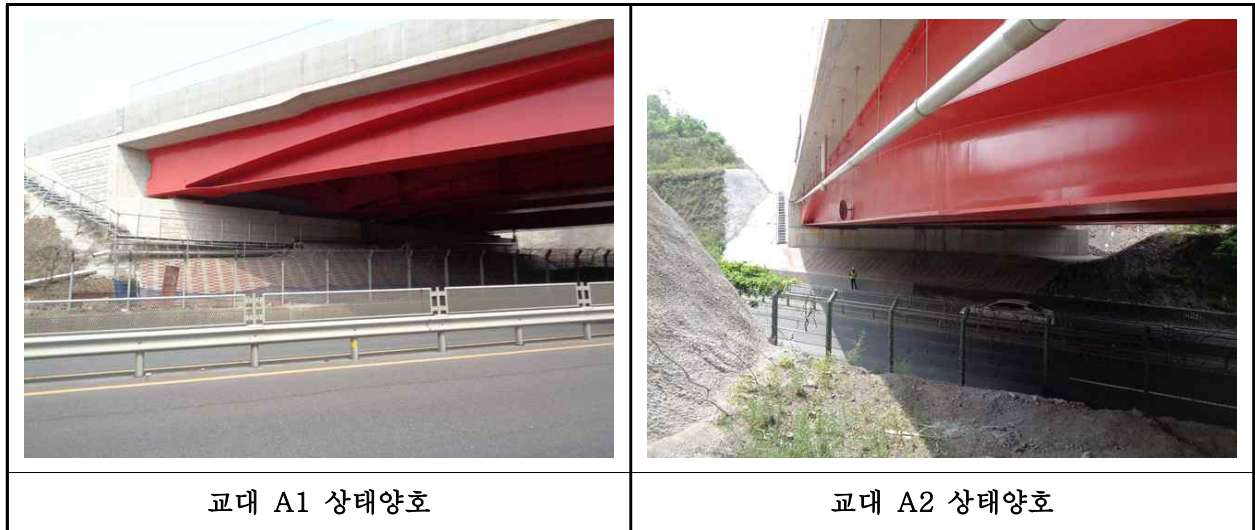
【사진 35.3.9】 교대 손상현황
