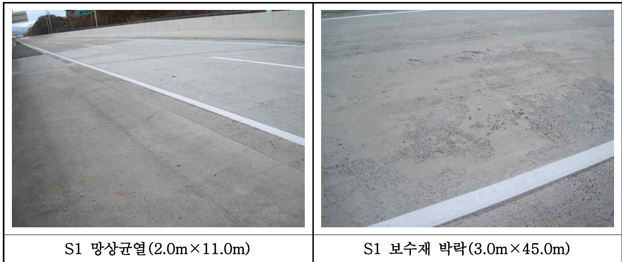
【사진 35.3.39】 교면포장 손상현황
